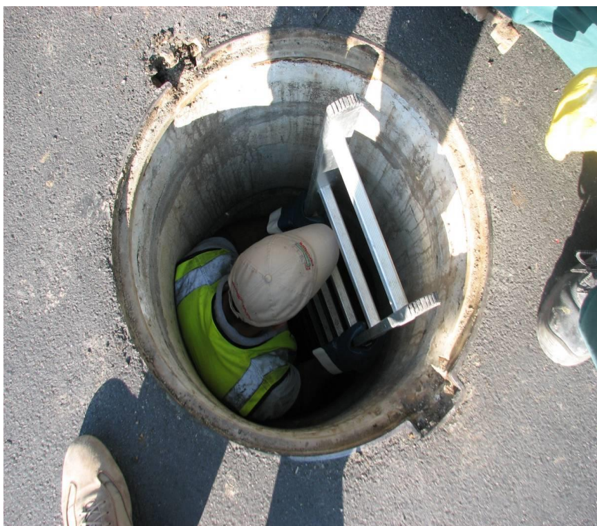
Fig. 1. Esempio reale. Un operatore scende in fogna di acque bianche per orientare una telecamera per video ispezioni. Risulta evidente la non sufficienza dell'allestimento sia per le dimensioni sia per l'impossibilità del recupero dell'infortunato (per gentile concessione di una degli autori).
