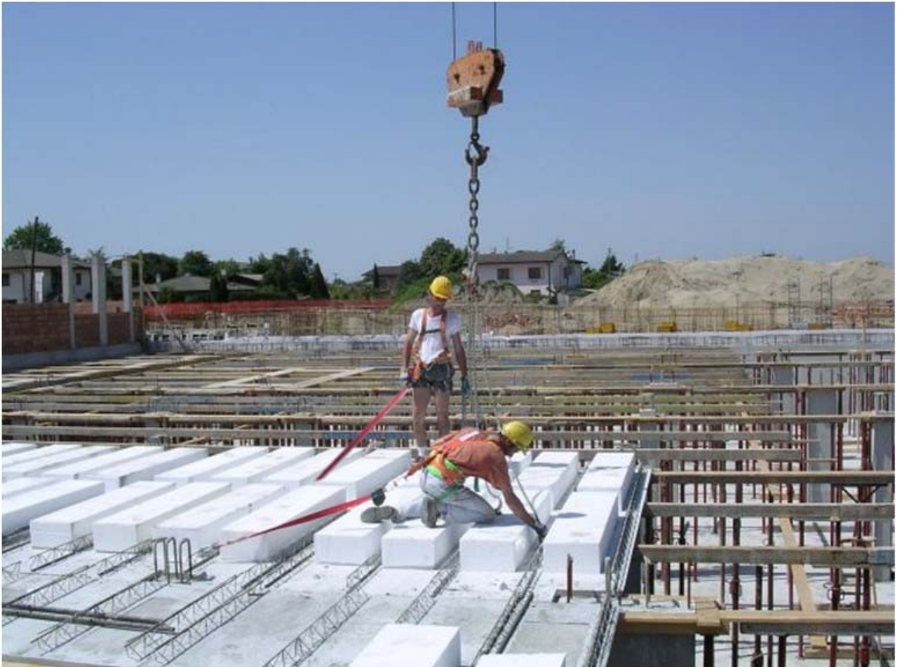
Figura 10. Solaio a pannelli caratterizzati dalla presenza di una superficie di lavoro continua.
