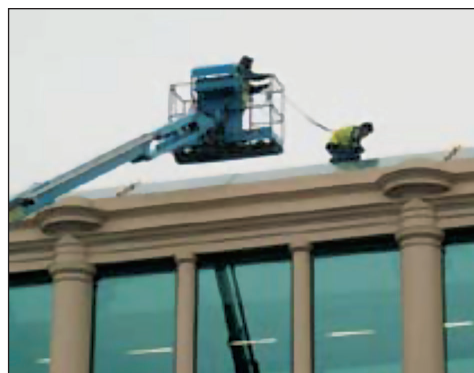
Figura 9 - Lavoro su una copertura con DPI anticaduta del lavoratore agganciato al cestello (situazione che in caso di caduta dell’operatore potrebbe determinare l’instabilità del mezzo)
