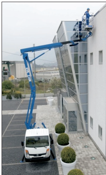
Piattaforma di lavoro mobile elevabile autocarrata (B1)
